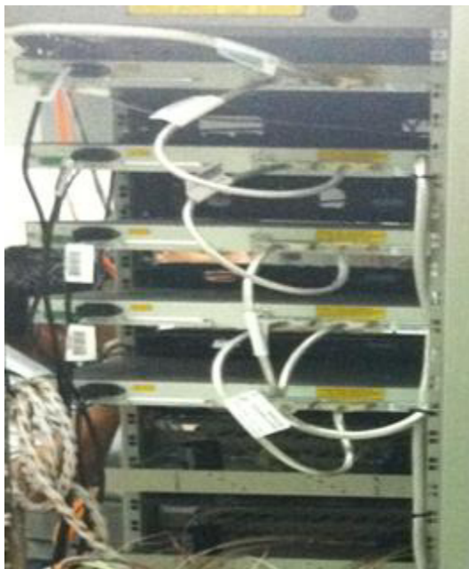
Figura 6. Situación actual 3COM 5500G-E en Stack
