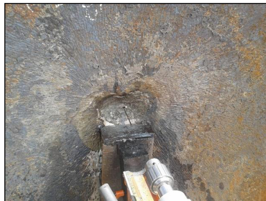
Figura 3. 4 Taladro de banco magnético montado para generar el barreno en la mazarota.
