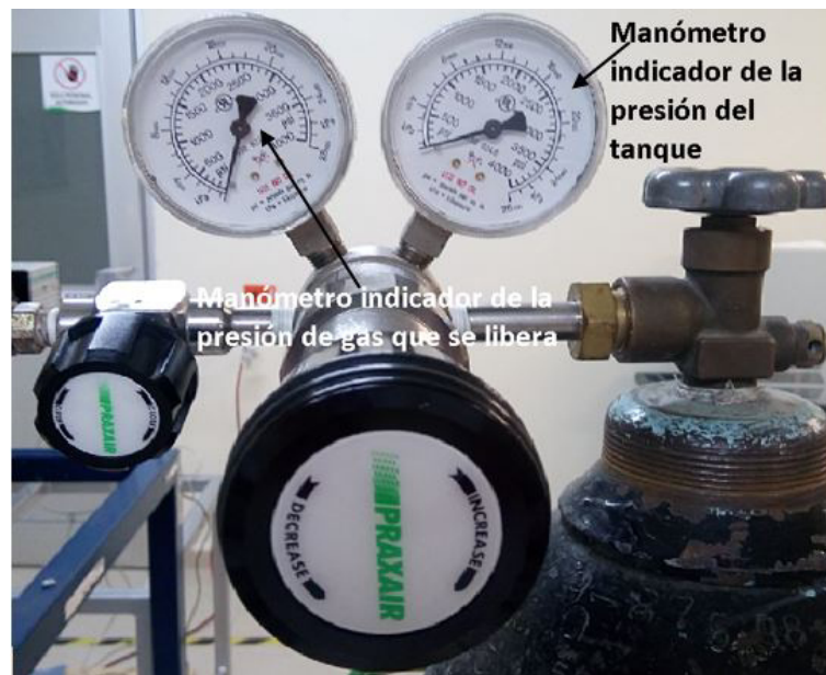
Figura 4.52: Válvulas de operación del tanque de nitrógeno.
