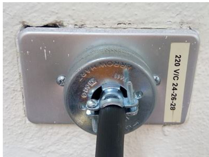
Figura 4.40: Cable de alimentación del motor eléctrico.
