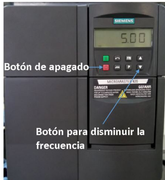
Figura 4.49: Apagado del variador de frecuencia.
