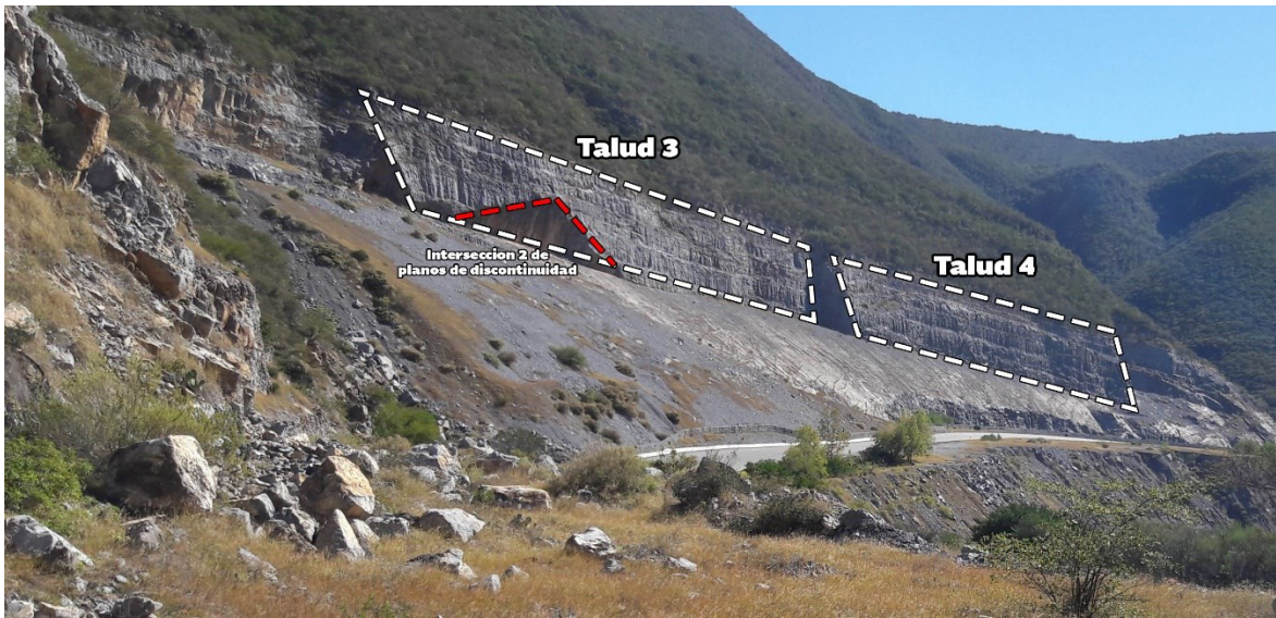
Ilustración 42.- Cortes al macizo rocoso en la unidad de Calizas Masivas Km. 11+000 que representan las caras de los taludes 3 y 4. Líneas rojas: Intersección de planos que forman cuñas.
