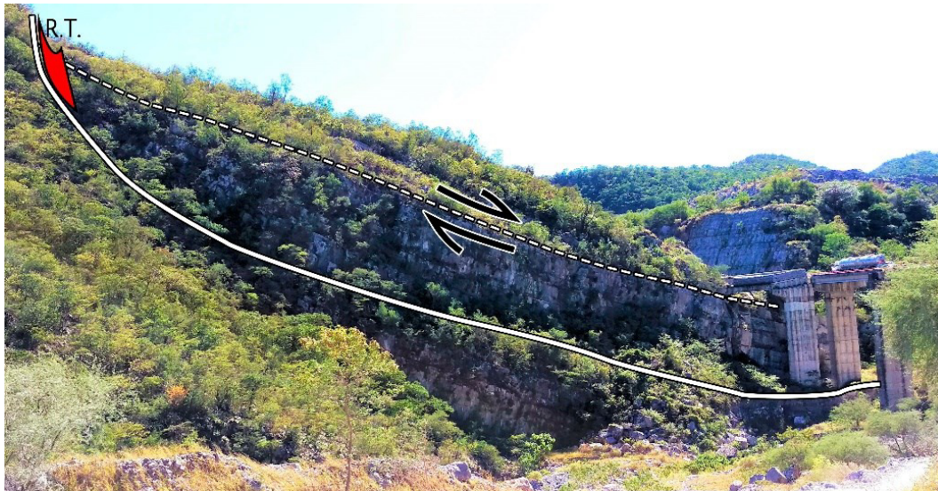
Ilustración 39.- Volumen con susceptibilidad a deslizarse de manera planar, Talud 1. R.T.: Ruptura de tensión. Línea sólida: Traza de estratificación y R.T. Línea punteada: Traza de deslizamiento. Km 10+300.
