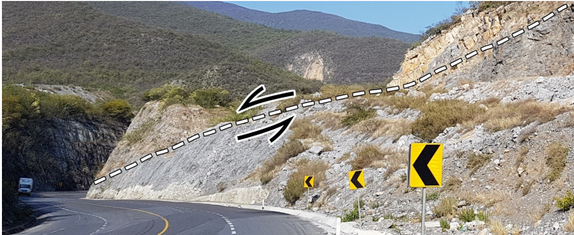
Ilustración 41.- Volumen con susceptibilidad a deslizarse de manera planar, Talud 2. Línea punteada: Traza de deslizamiento. Km 10+400.
