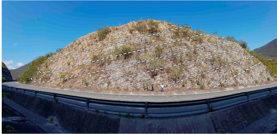
Ilustración 45.- Corte realizado en la unidad de Rocas Intercaladas, Talud 5, Km. 12+100. Líneas: Estratificación
