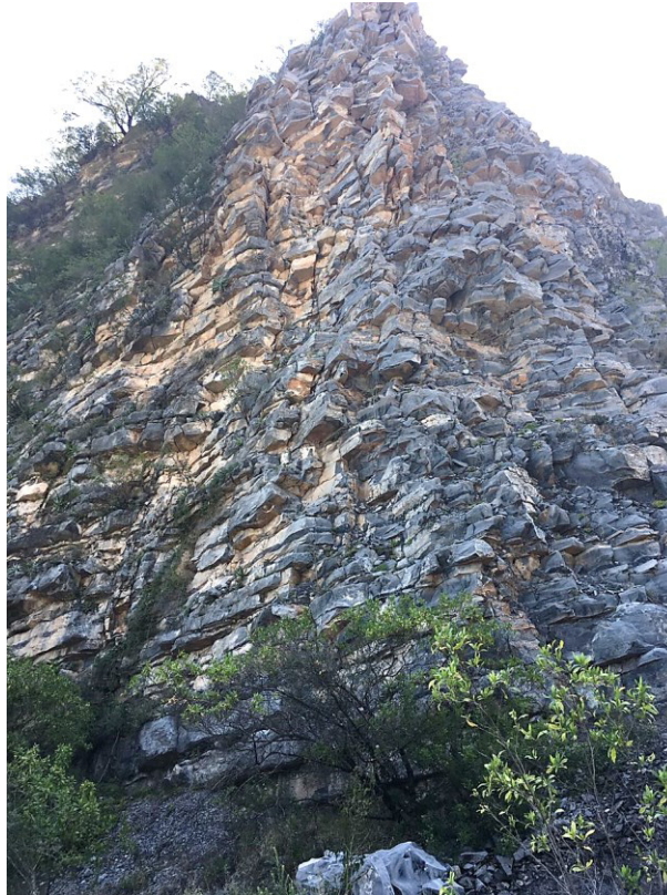
Ilustración 47.- Corte realizado en la unidad de Rocas Intercaladas en el Km. 12+350, en la que se presenta susceptibilidad de vuelcos. Talud 6.
