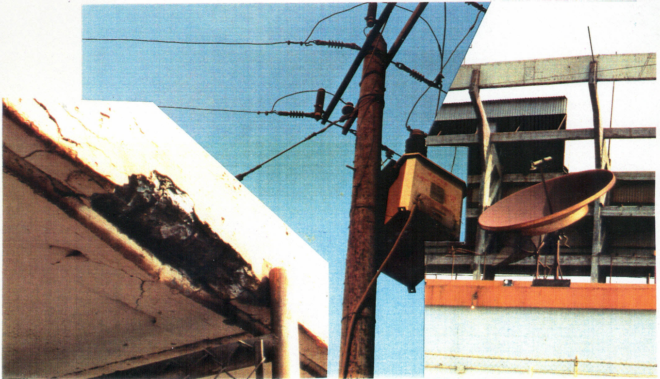
DAÑOS VISIBLES CAUSADOS POR LA CONTAMINACION DEL AIRE EN EL AREA DEL ESTADIO UNIVERSITARIO.
