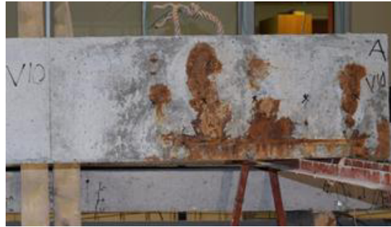
Figura 26: Condición superficial del concreto después del deterioro.
