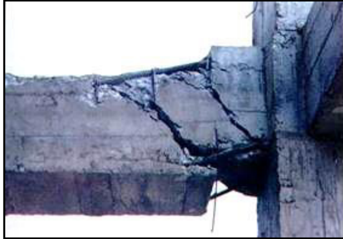
Figura 5: Agrietamiento en falla a cortante de vigas.
