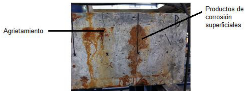
Figura 45: Daño por corrosión en viga de concreto reforzado
