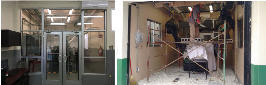
(a) Puertas y cristalera de seguridad.
