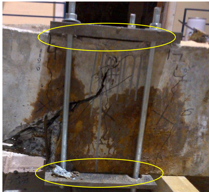
Figura 40.- Espaciamiento e irregularidades en la interface de placas de soporte de tensores externos.
