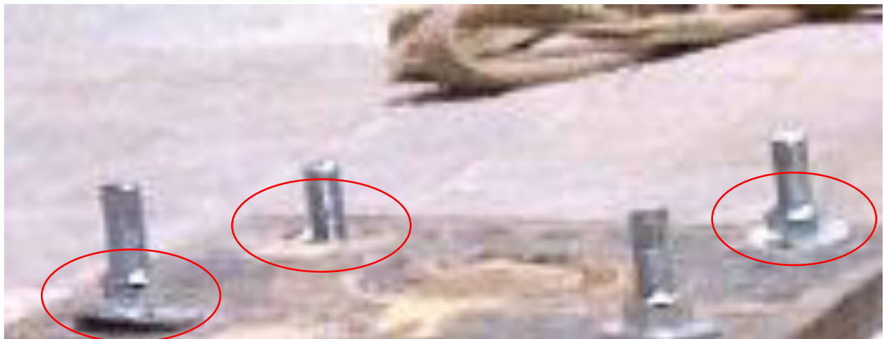
Figura 36. – Aplastamiento de rondanas por espesor insuficiente para soportar el esfuerzo en los tensores externos.
