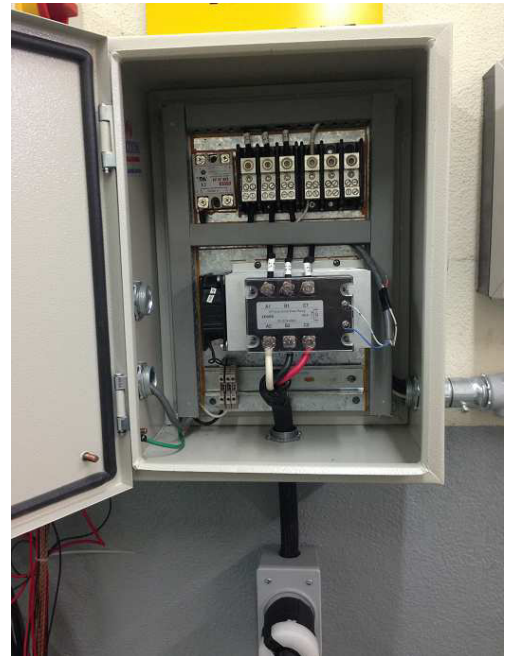
Figura 3.6: Caja de control para las tarjetas National Instruments (vista externa)
