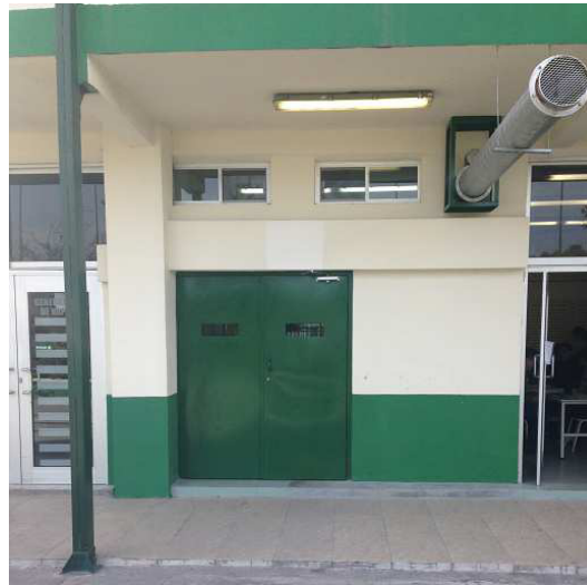
Figura 3.3: Vista exterior del sistema de extracción
