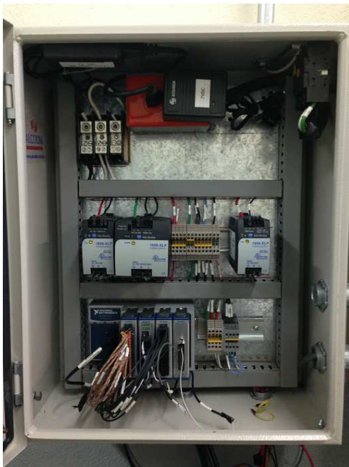
Figura 3.7: Caja de control para las tarjetas National Instruments (vista interna)
