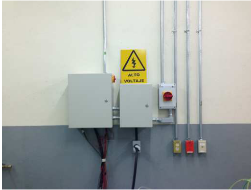
Figura 3.5: Cajas de control eléctrico
