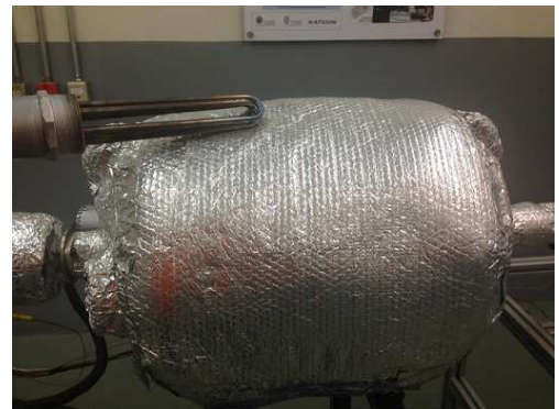
Figura 3.8: Resistencia eléctrica y sistema de recalentamiento de los gases
