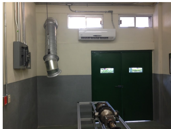
Figura 3.4: Vista interior del sistema de extracción
