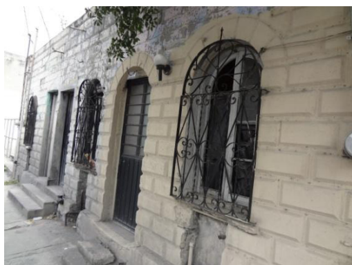
Figura 91. Patrimonio en deterioro.
