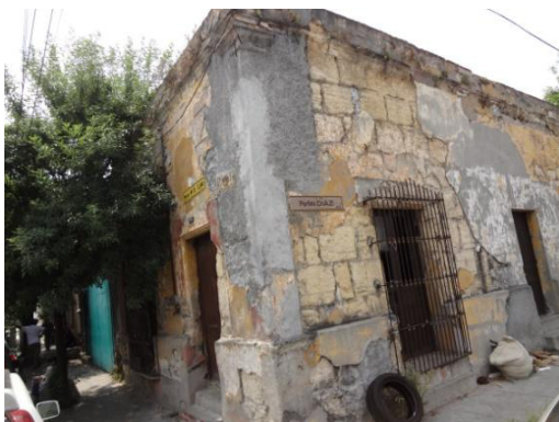
Figura 74. Arquitectura vernácula en deterioro.
