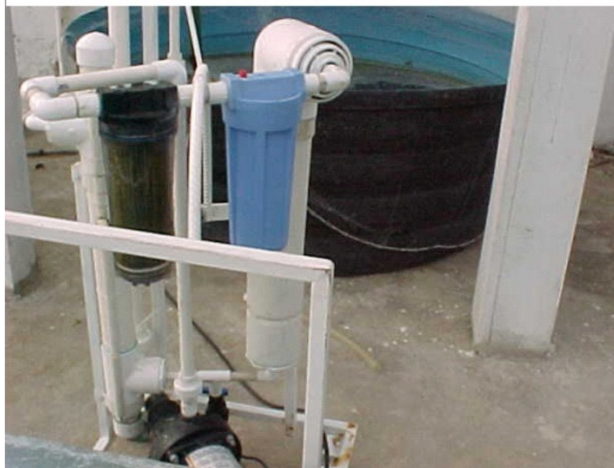
Figura 6. Dispositivo para la limpieza y eliminación de residuos sólidos en el fondo del tanque.
