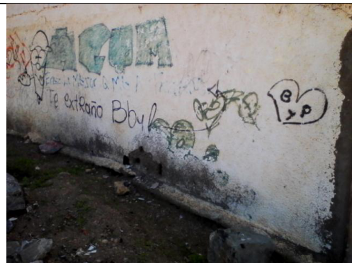
Imagen mostrando las manchas de eflorescencia en la parte baja del muro
