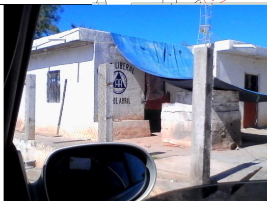
Vivienda que es utilizada como una casa o centro parroquial, presenta las manchas amarillentas en las partes bajas de su muro
