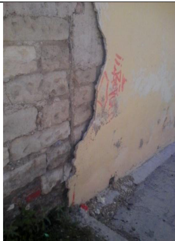
Imagen de los desprendimientos de pintura por la humedad en la vivienda contigua
