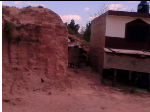
Esta imagen nos muestra otra vista de la propiedad donde carece de muro de contención y prácticamente el tiradero de relaves hace las veces de cerco perimétrico
