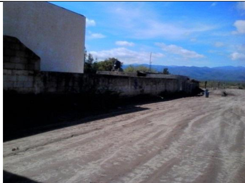
Vista desde la calle, donde se aprecia que los demás vecinos tienen el muro perimetral con manchas de eflorescencia
