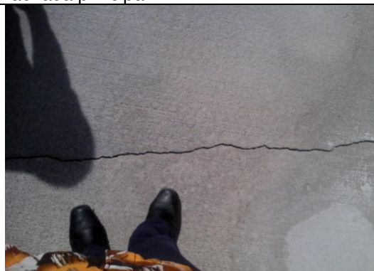
Imagen mostrando la fisura e piso producto de un microsismo que hizo desplazar las capas inferiores del suelo
