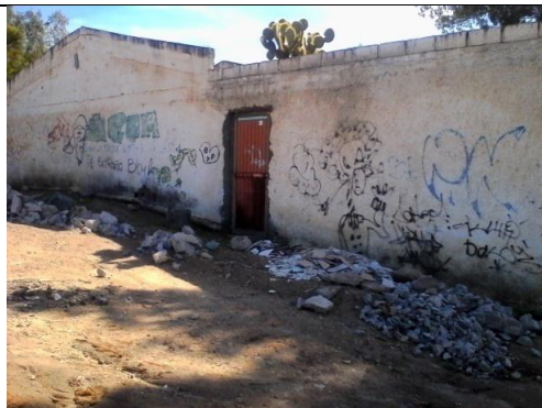
Vivienda en esquina mostrando la presencia de las manchas de eflorescencia a lo largo de todo el basamento
