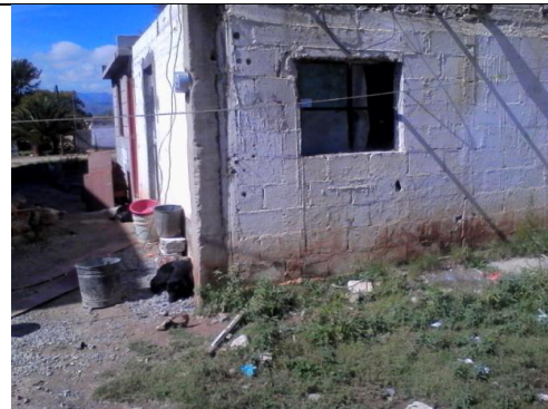
Otra vista de la misma vivienda pero en la tarde, donde puede apreciarse con mayor claridad el color naranja en las cimentaciones.
