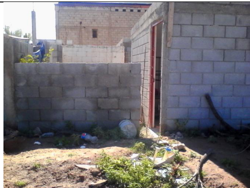
Una vista del otro muro contiguo con presencia de eflorescencia.
