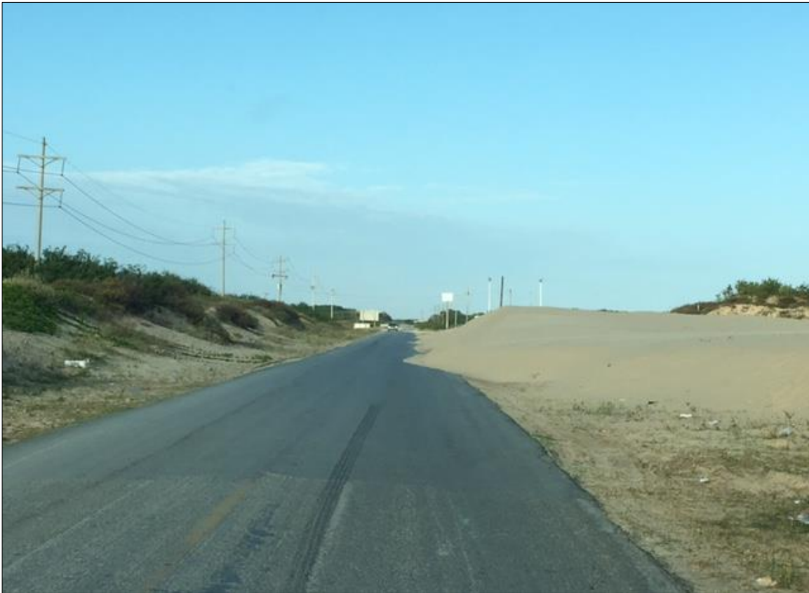
Figura 3.6 Alta erosión en la carretera que comunica Las Higuierillas. Fuente: Reporte Fotográfico propio 2016.
