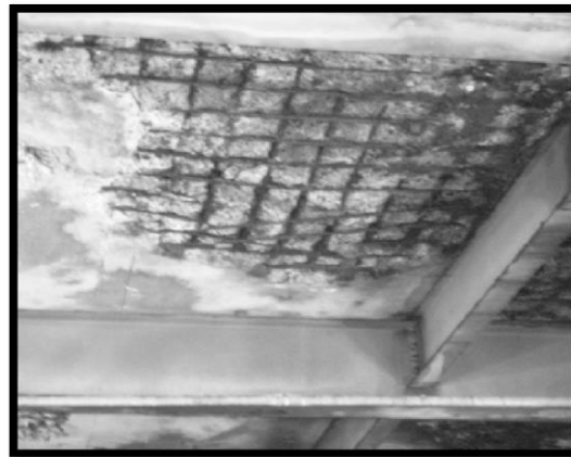
Fig. 40 Losa de concreto dañada por corrosión en un ambiente industrial, en la producción de cloruros en la industria química.
