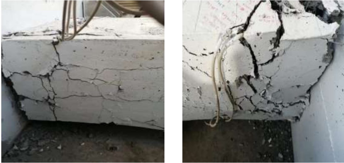
Fig. 82: Perspectiva general de fragmentación del concreto en la zona de articulación plástica.
