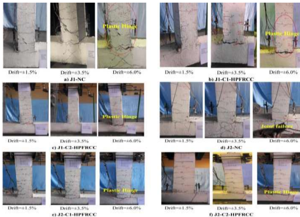
Fig. 23: Proceso de daño y agrietamiento [27].
