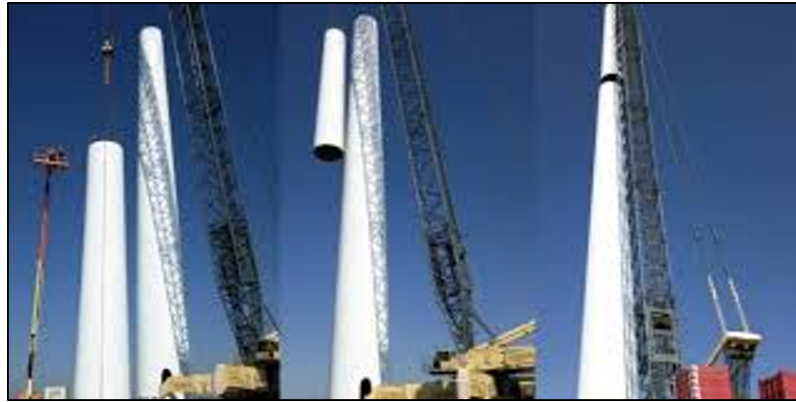
FIGURA 2.18: Torres de acero tubulares.
