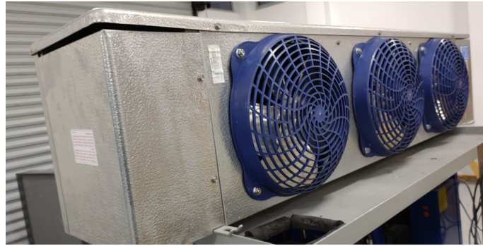
Figura 3.2: Evaporador seleccionado para la instalación experimental
