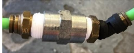
Figura 26. Ejemplo de arreglo de conectores con codo.
