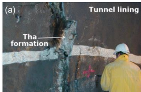
Figura 7.- Desprendimiento del concreto revestido en un túnel, debido a expansiones internas provocadas por sulfatos [25].
