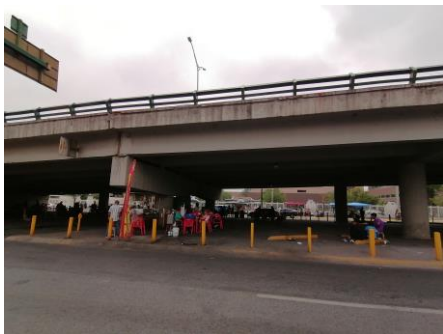
Figura 1.9 Condiciones de poca higiene en los bajos del puente de la avenida “Dr. José Eleuterio González” frente al Hospital Universitario en Monterrey, Nuevo León, México. Fecha: 27 de mayo de 2020. Fuente: José Antonio González Espinoza.
