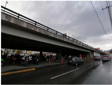
Figura 1.8 Condiciones de poca higiene en los bajos del puente de la avenida “Dr. José Eleuterio González” frente al Hospital Universitario en Monterrey, Nuevo León, México. Fecha: 17 de septiembre de 2020. Fuente: José Antonio González Espinoza.
