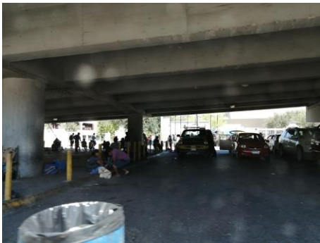
Figura 1.10 Condiciones de poca higiene en los bajos del puente de la avenida “Dr. José Eleuterio González” frente al Hospital Universitario en Monterrey, Nuevo León, México. Fecha: 22 de agosto de 2021. Fuente: José Antonio González Espinoza.
