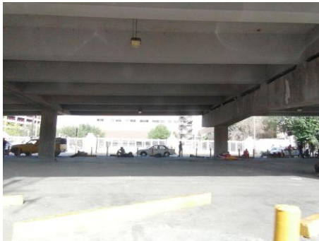
Figura 1.11 Condiciones de poca higiene en los bajos del puente de la avenida “Dr. José Eleuterio González” frente al Hospital Universitario en Monterrey, Nuevo León, México. Fecha: 29 de agosto de 2021. Fuente: José Antonio González Espinoza.
