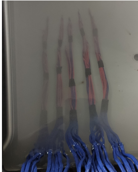
(a) Instalación de los termopares para calibración
