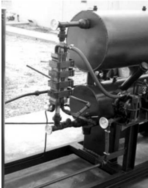
Figura 21 . Fotografía de un generador de energía termoeléctrica que produjo energía para la protección catódica del pozo y la línea de gas, que utilizó la diferencia de temperatura entre las etapas fría y caliente del ciclo del deshidratador de gas natural con glicol [28].
