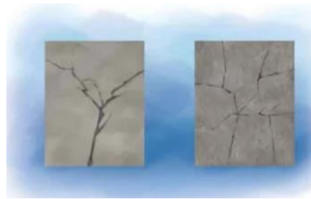
Figura 4. Explosión de concreto.
