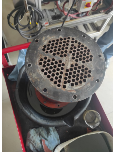
FIGURA D.3: Tubos internos del intercambiador de calor
