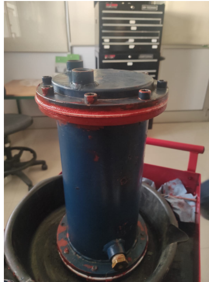
FIGURA D.5: Intercambiador de calor limpio.
