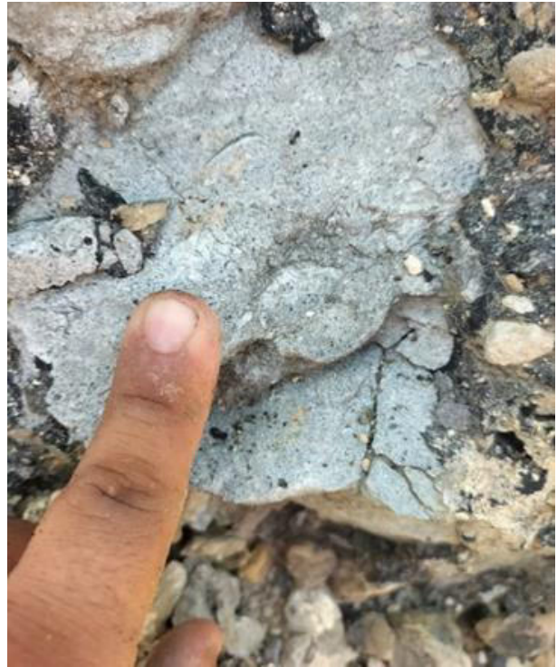
Fig. 10: Roca que presenta porosidad secundaria por fractura y por disolución (porosidad vugular) de la misma. Punto 2
