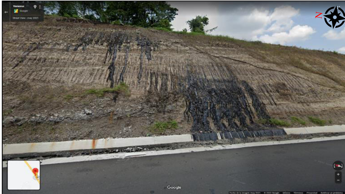
Fig. 9: Sección de cerro cortada en la construcción de la Autopista Tuxpan - Tampico, Km 62. Punto 2 Coordenadas 21.396519, -97.673142. (Google Maps 2021).
