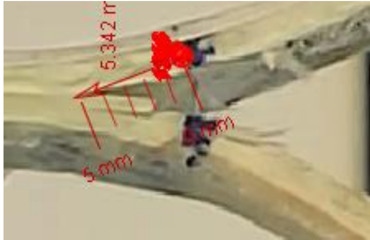
Figura 3.20 Medición de delaminación
