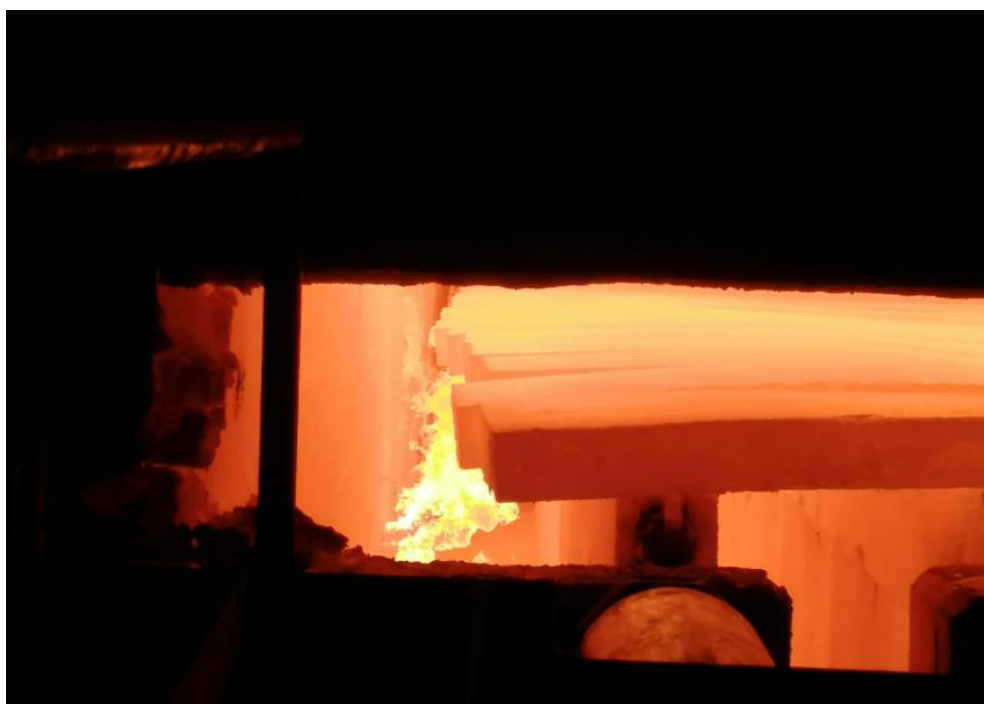
Figura 13. Vista interna del horno donde se observa la flama de salida de los quemadores
