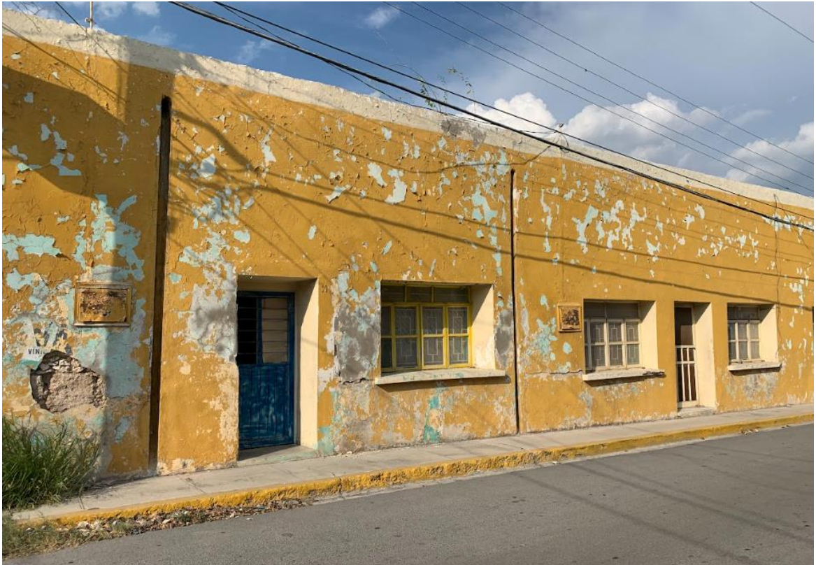
Figura 49 Vivienda con presencia de lloraderos o llorones
