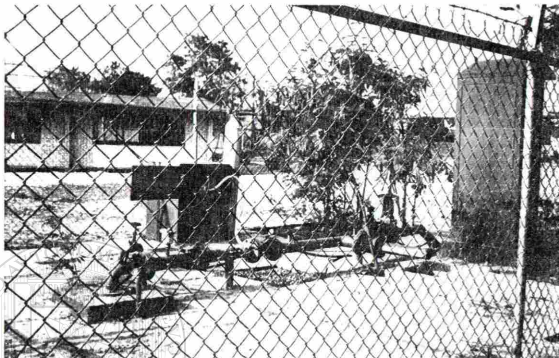
Pozo No. 26 Central Escuela
