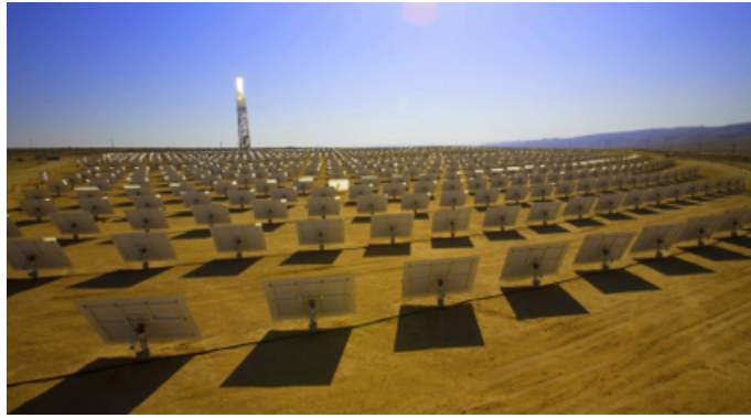
FIGURA 2.1: Campo de heliostatos centralizados (Global Nevada Corp 2011).
