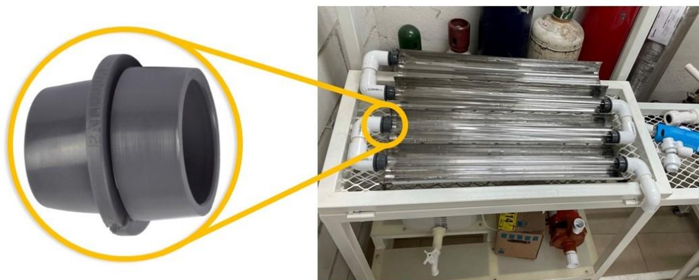
Figura 34. Conexión desmontable entre la tubería de PVC y fotorreactores de vidrio borosilicato utilizando chupones flexibles de PVC.
