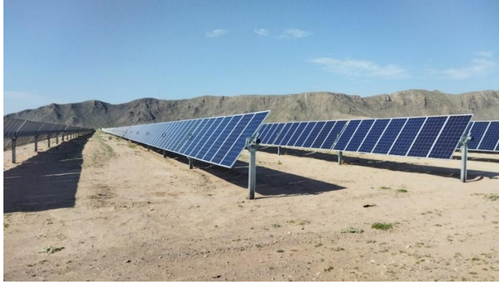
Figura 4: Paneles solares en el Complejo Parque Villanueva Solar.
