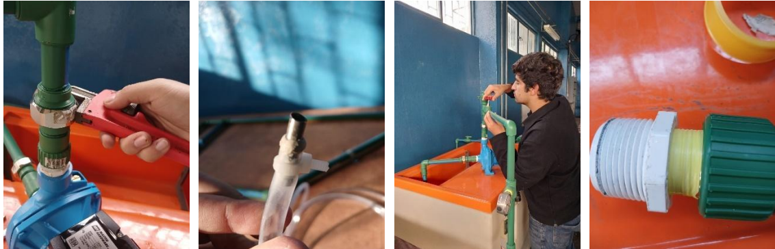
Figura 20. Identificación y reparación de fugas.
