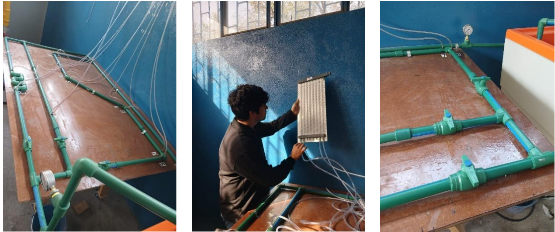
Figura 18. Correcciones del sistema hidráulico.
