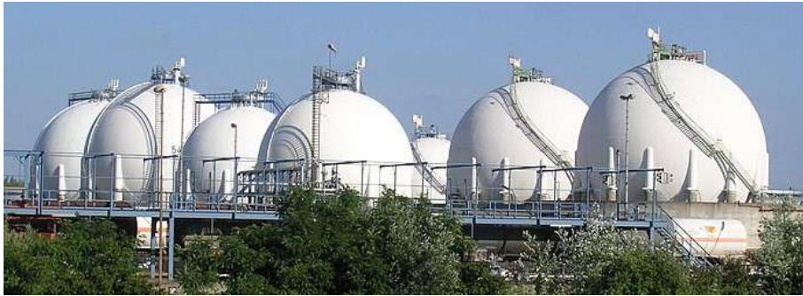
FIGURA 2.7: Tanques de almacenamiento esféricos.
