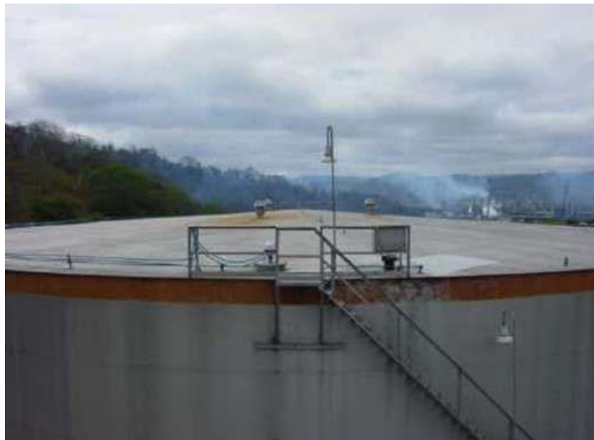
FIGURA 2.9: Tanques de almacenamiento con techo fijo.
