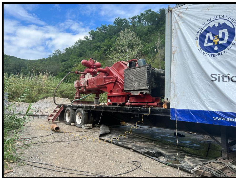
Figura 50. Equipo de bombeo utilizado por Servicios de Agua y Drenaje de Monterrey durante las actividades operativas asociadas al pozo de inyección profunda en el área de estudio Galería Los Elizondo.
