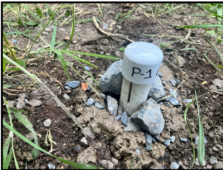
Figura 52. Piezómetro instalado para el monitoreo.
