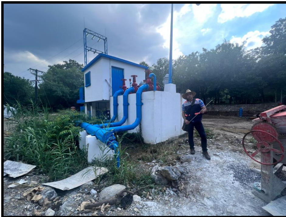
Figura 51. Vista de la caseta y tuberías utilizadas para la conducción y control del agua hacia el pozo en el sitio Galería Los Elizondo.
