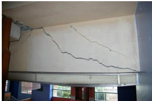
Figura 1. Falla tipo frágil por adherencia en trabe de concreto.
