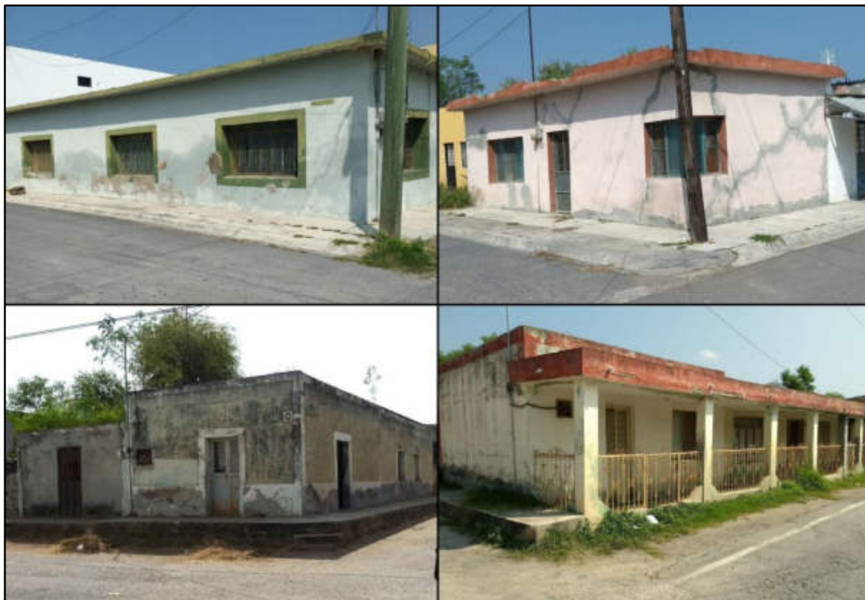
Figura 42. Viviendas en la localidad de China, N.L. que presentan problemas de humedad y ensalitramiento (elaboración propia, 2021).
