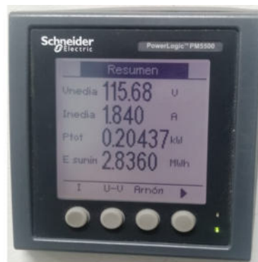
FIGURA 3.18: Medición de parámetros eléctricos del equipo de refrigeración
